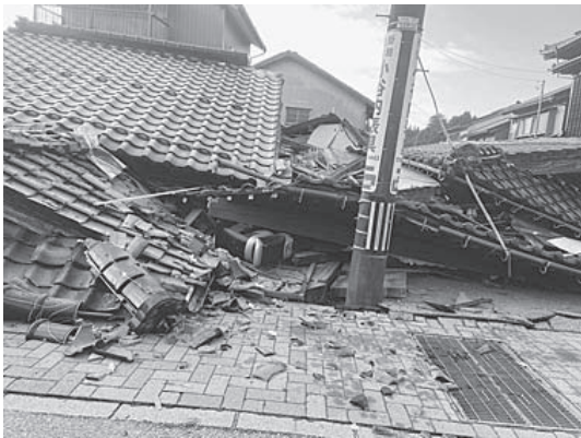
令和6年1月20日 石川県七尾市の被害状況
